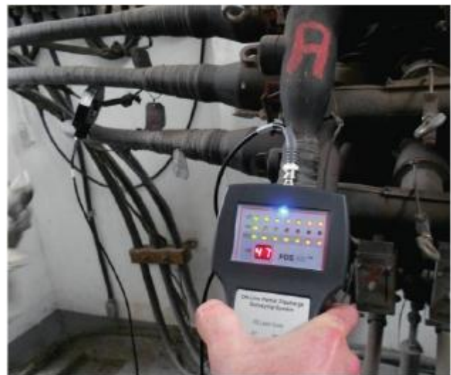
TE-Messung an einem MS-Kabel mit dem HFCT Sensor.
