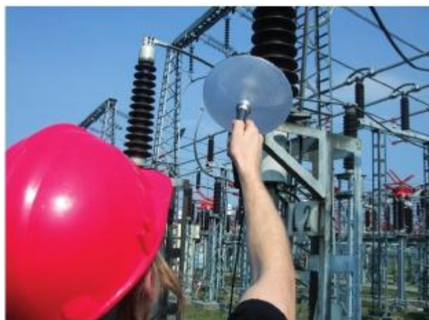
TE-Messung an HS-Endverschlüssen mit der optional erhältlichen Parabolantenne.
